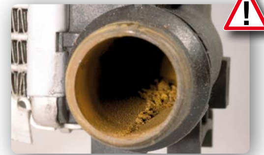
Rost im Kühler
